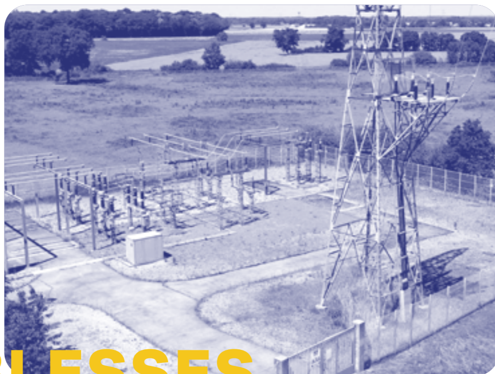
Réseau électrique — Saint-André-de-Corcy
